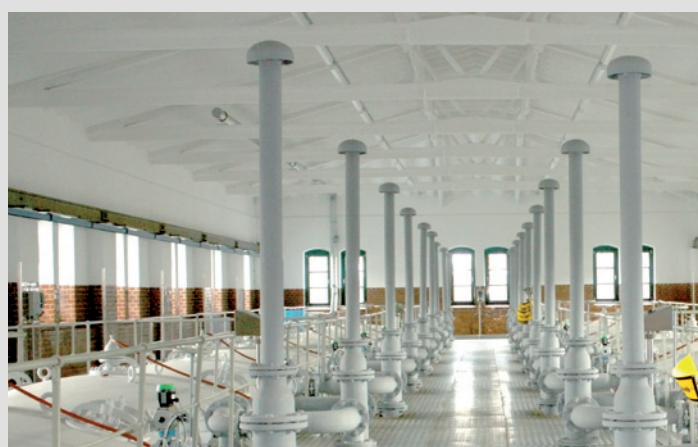
Mit KefaTherm behandelte Bollmannfilteranlage eines Wasserwerkes.
